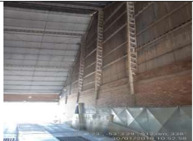
Cobertura do tombador
