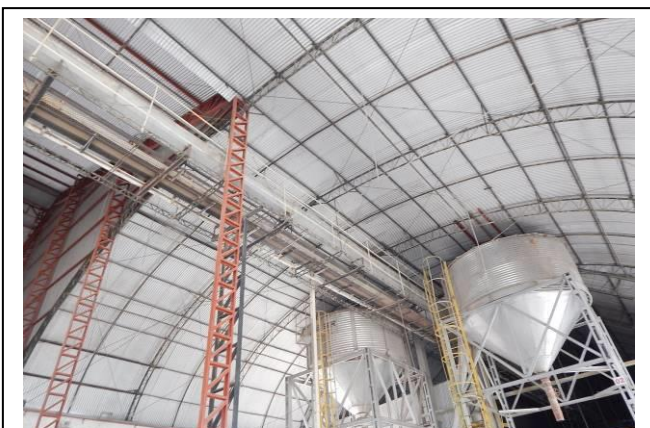
ESTEIRA TRANSPORTADORA ESTRUTURA EM
