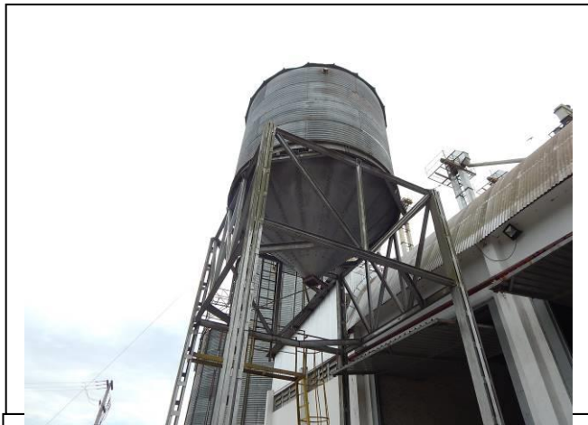
SILO METALICO DE QUIRERA 50TON.
