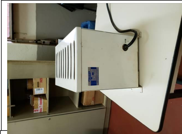
TRANSFORMADOR ITALUX S. 23420/96
