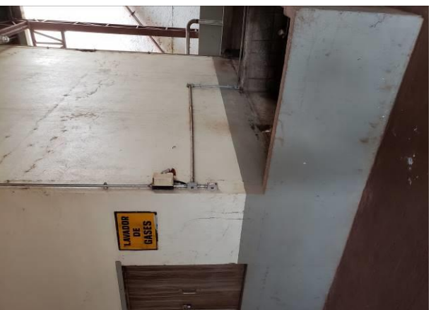
LAVADOR DE GASES TIPO TANQUE
