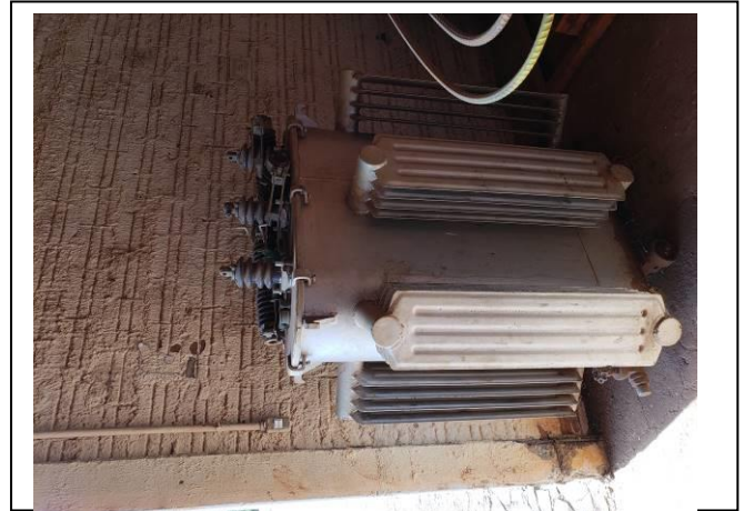
TRANSFORMADOR AEG TIPO RID 2266/15
